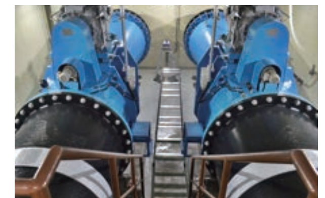
▲赤川地区小水力発電所 内部風景
